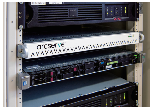
甲南女子大学 管理棟 2 階の情報処理センターに設置された Arcserve UDP Appliance 7300。複数の学内サーバのバックアップデータを本製品で一元管理する。
